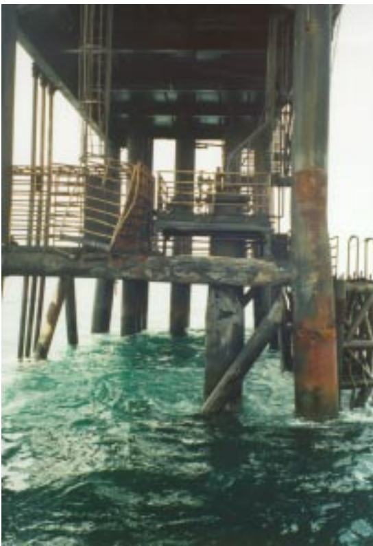
Bild 17: Schäden an der KCDP-B
