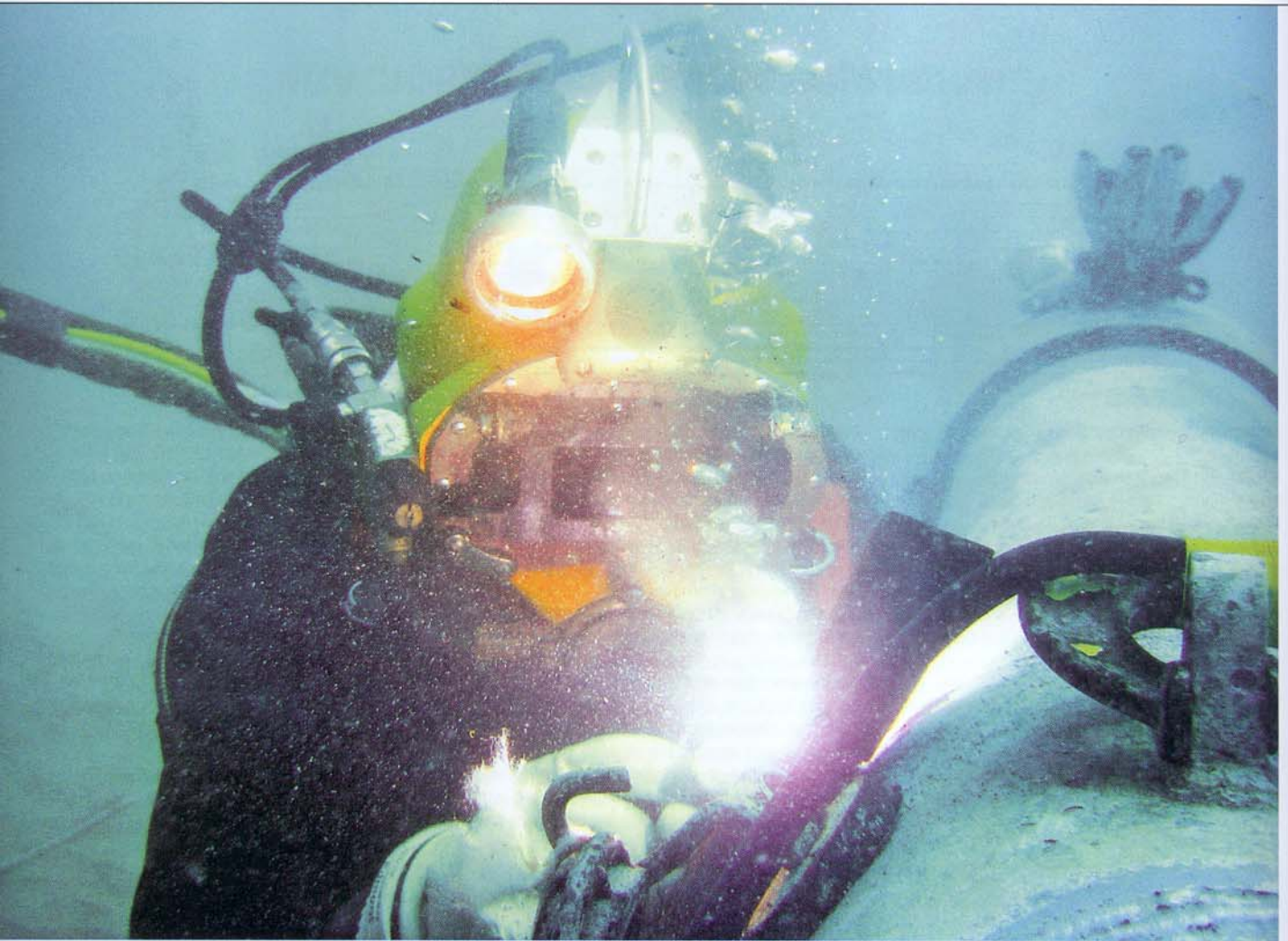
Beim so genannten „Hyperbaric Wet Welding“ findet der Schweißvorgang direkt im Wasser statt
